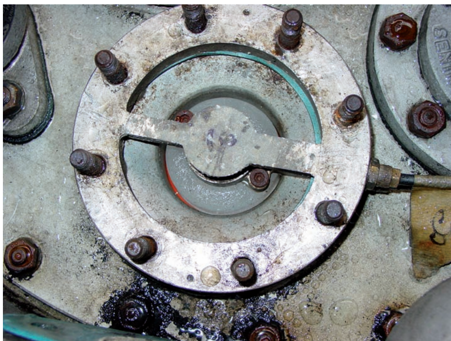
Bild 1: Vereistes Kippventil mit engem Ringspalt zwischen Eis und Wand, der zu einem unzulässig hohen Druck geführt hat
