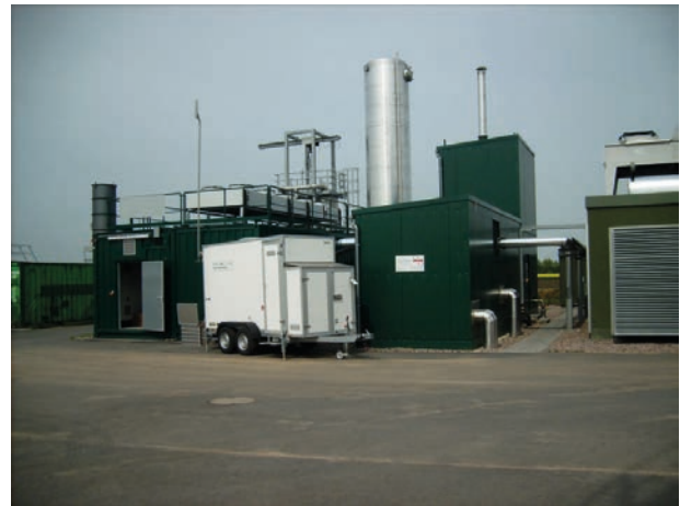
Bild 5: Biogasaufbereitungsanlage mit dem PTB-Messanhänger im Vordergrund
