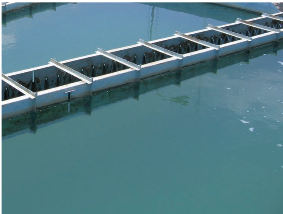
Trinkwasseraufbereitungsanlage in Arequipa, Peru
