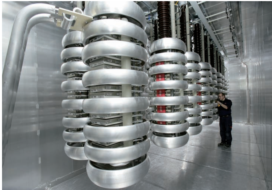
Bild 5: Konverter einer Hochspannungs-Gleichstrom-Station (Foto: ABB)
