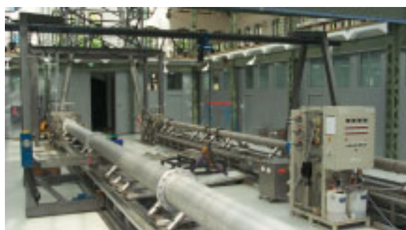
Bild 5: Die neue große Wärmeenergiemessanlage der PTB im Hermann-von-Helmholtz-Bau
