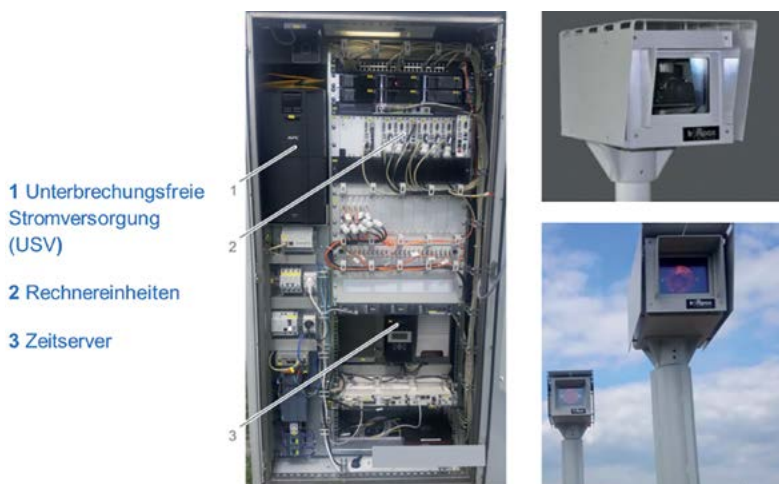
Bild 4: Details von Schaltschrank und Fotoausrüstung an einem Portal
