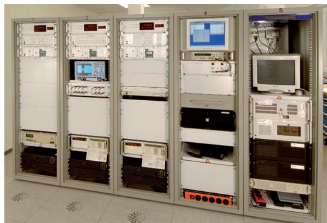
Bild 8: DCF77-Steuereinrichtungen der PTB. In den Racks 1–3 sind die Atomuhren, Signalgeber und elektronischen Umschalter eingebaut. Rack 4 enthält die lokalen Messeinrichtungen und die Schnittstelle für die Kommunikation zwischen Mainflingen und Braunschweig. Rack 5 enthält die Schnittstelle für die Einspeisung von Alarm- bzw. Wetterinformation.
