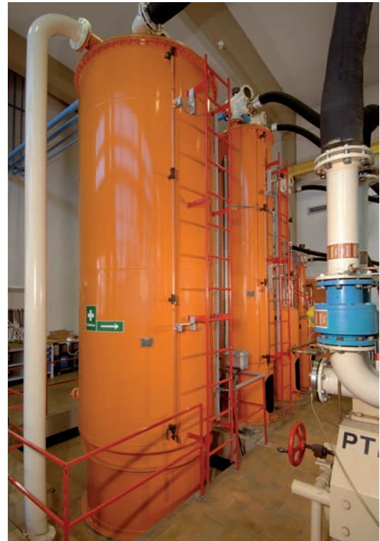
Bild 4: Normalbehälter des Mineralölzähler-Prüfstandes mit Fassungsvermögen von 5000 Liter, 1000 Liter, 200 Liter und 100 Liter
